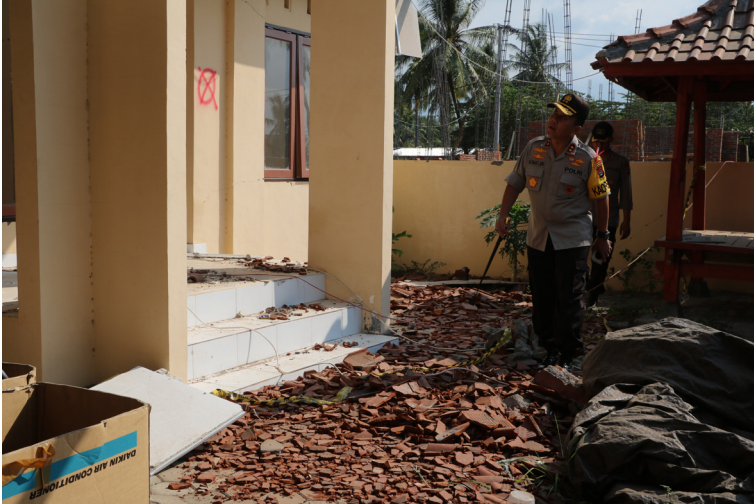
Rumah Dinas Kapolres Lotara turut berantakan diguncang gempa bumi. Foto: Kapolda tengah mengecek kondisi rumah dinas yang rusak parah
